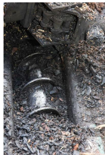
Situation après un retour de braises depuis le local abritant la chaudière : après l'évacuation du matériau concerné, il s'est avéré que la carbonisation des plaquettes de bois ne s'était pas seulement produite dans la couche supérieure, mais aussi en profondeur le long de tout le conduit de convoyage. (Photo : IFS/Schallmoser*)
