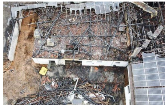
Drohnenaufnahme eines landwirtschaftlichen Gebäudes nach einem Brand, ausgehend von einem Holz hackschnitzzellager. (Bild: IFS/Schallmoser*)
