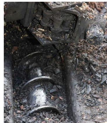
Situation nach einem Rückbrand aus dem Ofenraum: Beim Freilegen zeigt sich, dass die Hackschnitzel nicht nur oberflächlich, sondern auch in der Tiefe in der gesamten Austragung verkohlt sind. (Bild: IFS/Schallmoser*)
